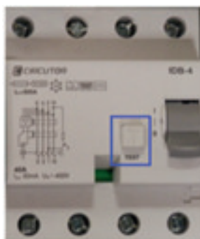
Figura 38: Botón Test del dispositivo de protección diferencial.
